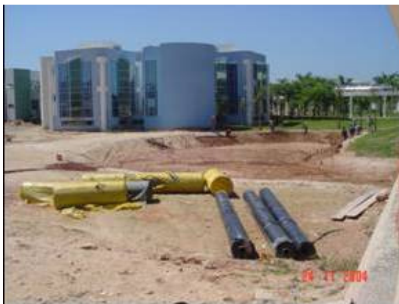
Bobinas de Manta Geotêxtil Bidim RT-21 e de geomembrana prontas para instalação.
