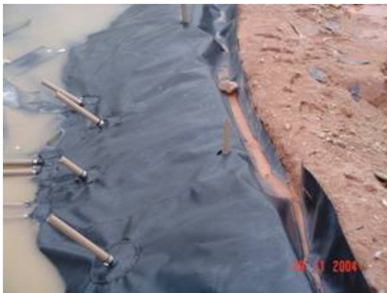
Geomembrana instalada sobre a Manta Geotêxtil Bidim RT-21. Notar as tubulações de água e a valeta de ancoragem da geomembrana na crista do talude.
