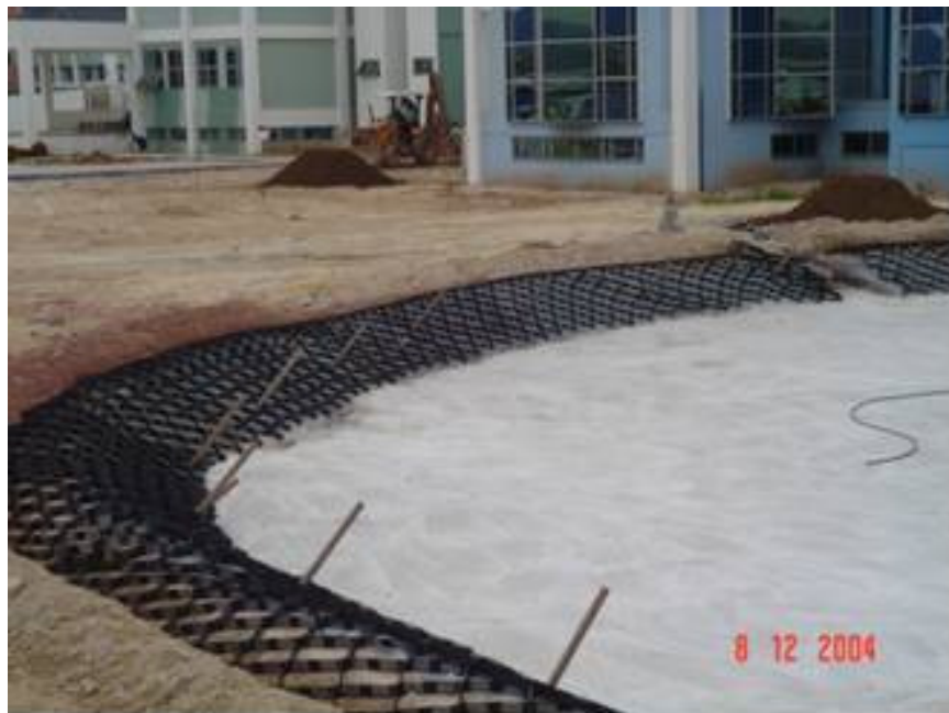
Fundo da lagoa já concretado e Geoweb já instalado nos taludes laterais.
