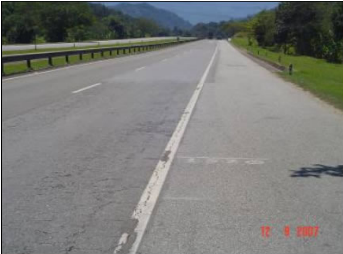
Figura 1: Estas fotos descrevem o estado inicial do pavimento antes da execução dos serviços- 12-09-07
