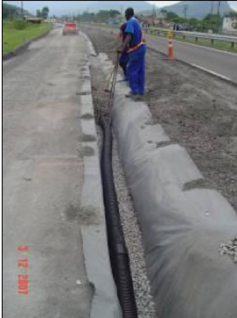
Figura 7: Imagem do lançamento da Brita e do Tubo Dreno Kananet DN170 mm no interior da trincheira drenante.
